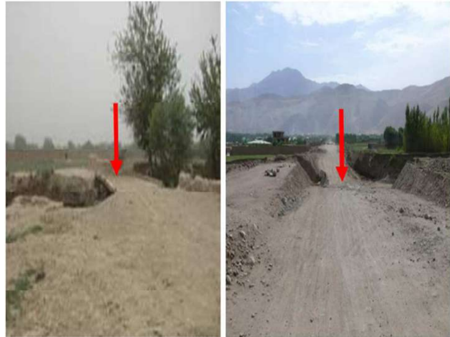
Ділянки звуження доріг
