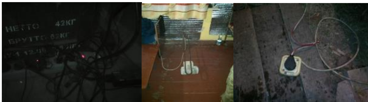
Рисунок 23 – типові порушення під час експлуатації електричних нагрівальних приладів в районі ООС (раніше АТО).
