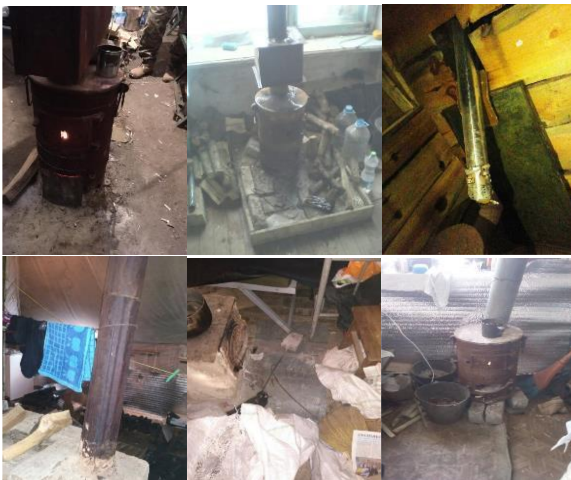
Рисунок 22 – типові порушення під час експлуатації металевих печей в бліндажі в районі ООС (раніше АТО).
